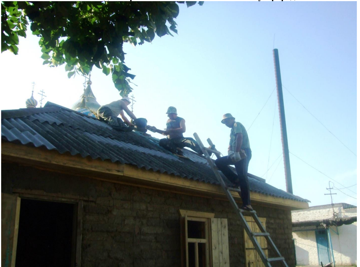
Трубу кладёт Александр Павлович Будко. Ему помогают Эдуард Анатольевич Фарафонов и Олег Николаевич Кирьянов.
